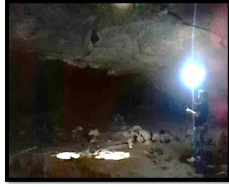
الصورة (30): تشقق السقف وهبوط وسطه.
