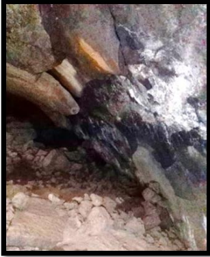
الصورة (38): انهيار قواعد البطانة الداخلية للجدار الأيمن.
