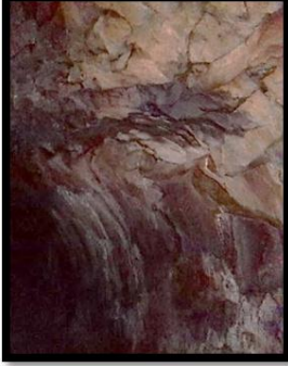
الصورة (16): خطر الحجارة المترصص في الجدار خلف البطانة
