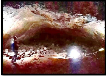
الصورة (31): هبوط البطانة الداخلية للسقف وتكشف مكونات الطبقة التي تعلوه.
