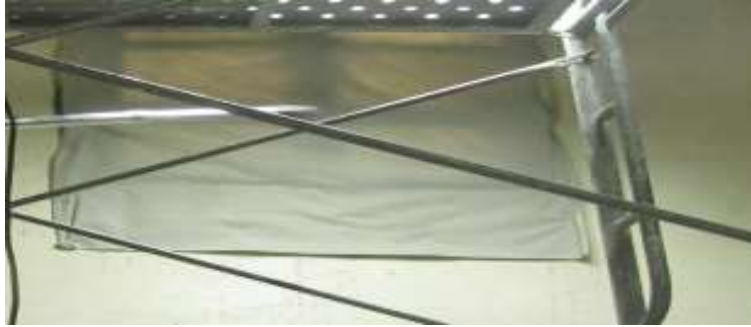
الشكل رقم (12) صورة توضح اغلاق النوافذ بقماش خاص لمنع أشعة الشمس المباشرة
