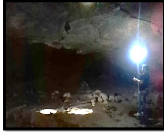
الصورة (30): تشقق السقف وهبوط وسطه.
