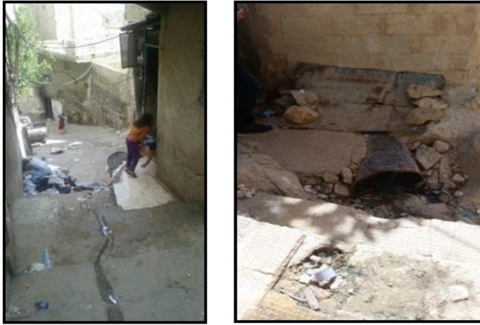
الصورتان (14- 15): تدمير أنابيب الصرف الصحي، وتراكم النفايات.
