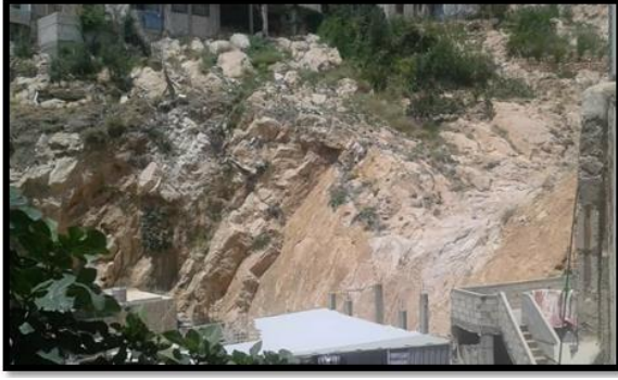
الصورة(18) بداية جرف السد الصخري وإشرافه على المباني
